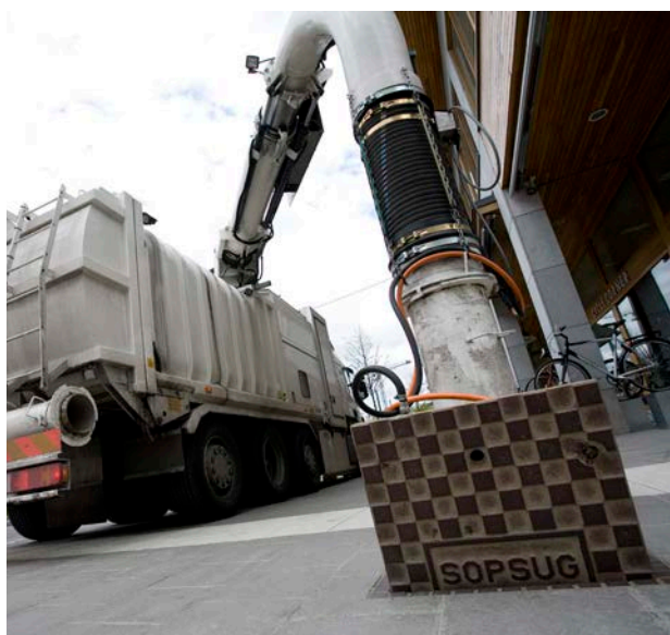
Mobil sopsug kopplad till dockningspunkt belagd i marknivå. FOTO: AVFALL SVERIGE
